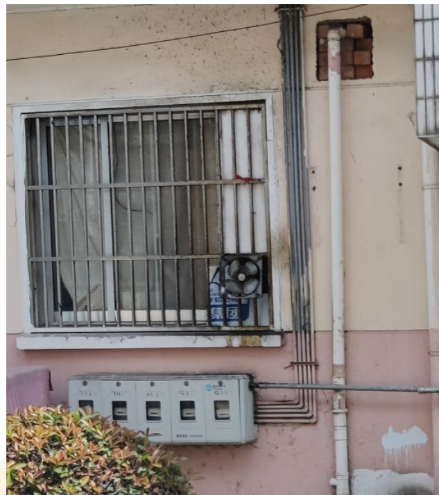
燃气设施现状
