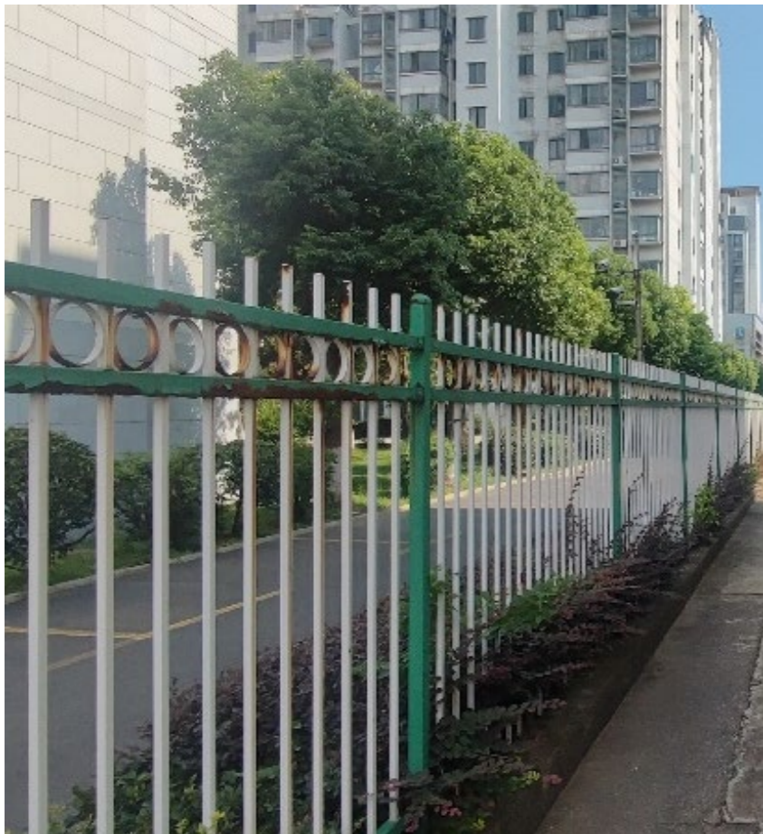
现状铁栏杆存在不同程度锈蚀风化现象
