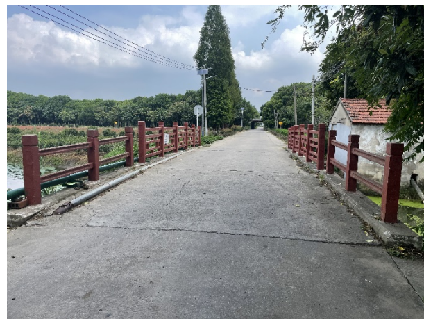
桥面存在自来水管
