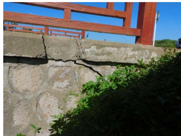
侧墙斜向开裂
