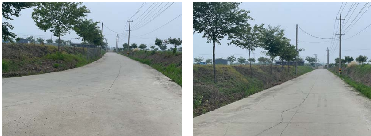
路面病害照片
