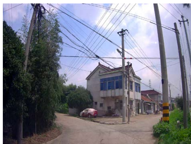
道口标柱老化、缺失
