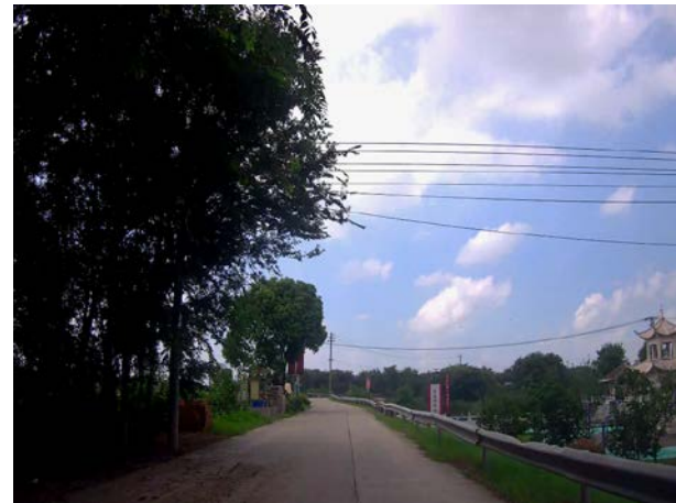
波形梁护栏损坏
