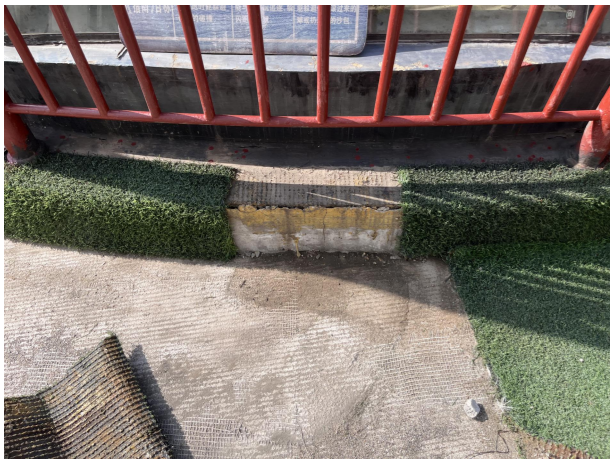
屋面保护层开裂，防水层被破坏，局部女儿墙没有增加附加防水层
