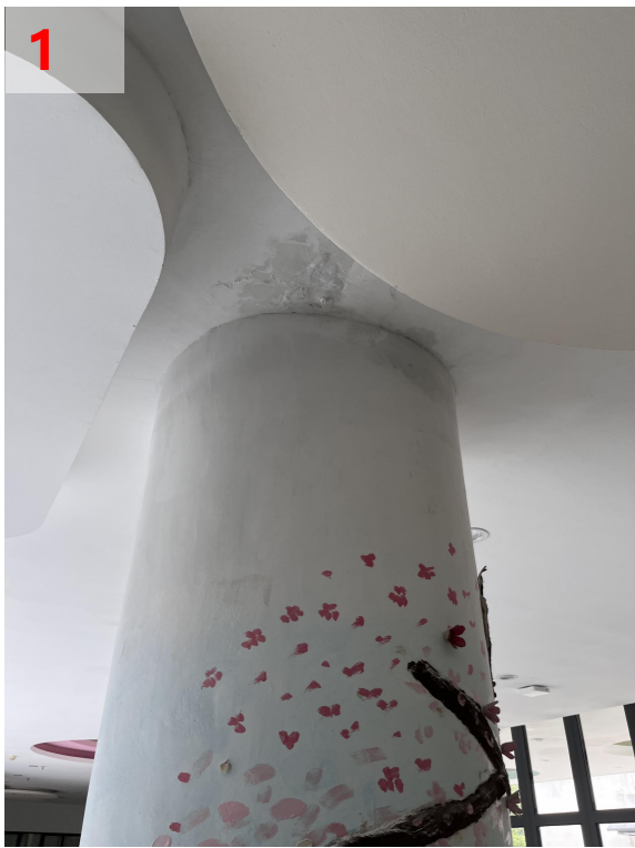
1 一层大厅顶面及墙面渗水
