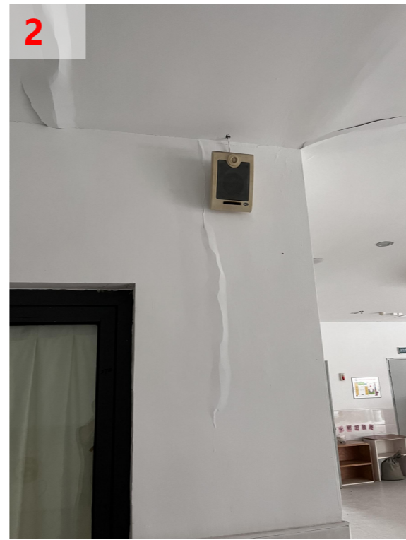
2 一层西侧顶面多处渗水
