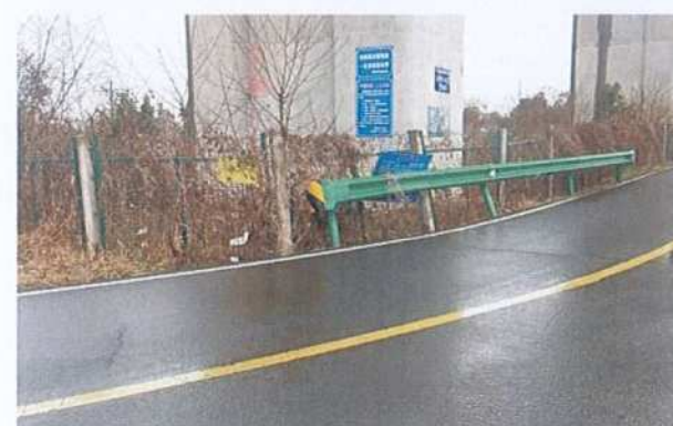
下穿铁路桥墩上行护栏损坏
