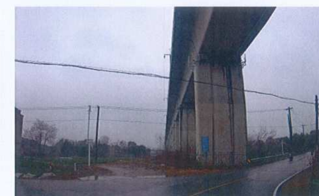
下穿铁路桥墩下行防护长度不足
