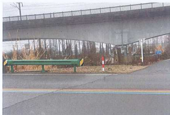
桥头护栏损坏
