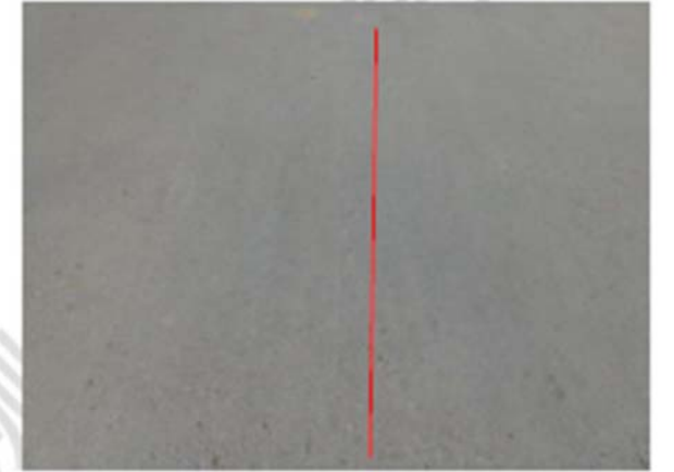
图 2.3-4 1#联桥面铺装纵向裂缝
