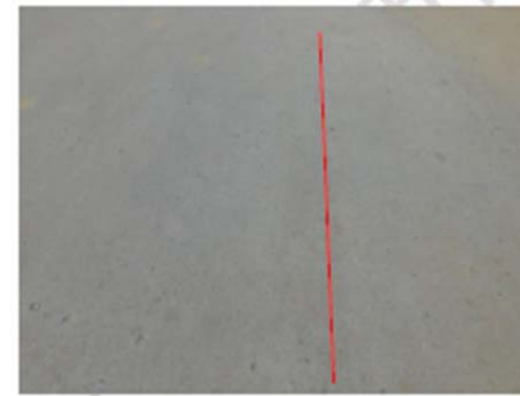
图 2.3-5 1#联桥面铺装纵向裂缝
