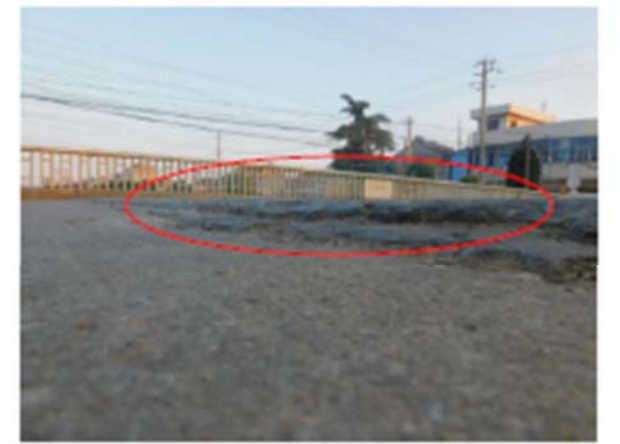
图 2.3-6 1#联桥面铺装桥头跳车、高差约 4.0cm
