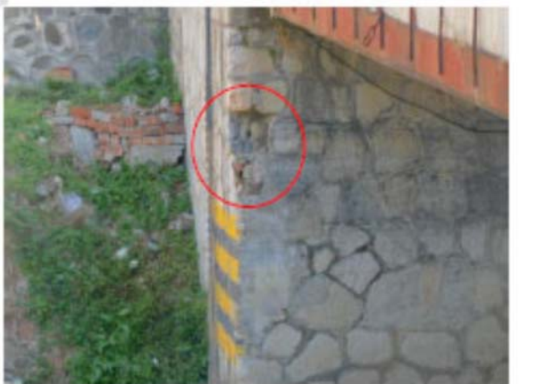
图 2.2-2 0#台身前墙砌块破损、露筋锈蚀
