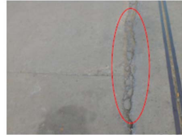
图 2.3-3 1#联桥面铺装剥落
