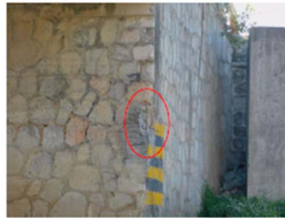
图 2.2-4 1#台身前墙砌块破损、露筋锈蚀
