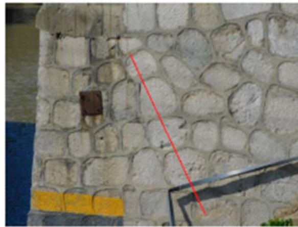
图 2.2-3 0#台身左侧墙斜向开裂
