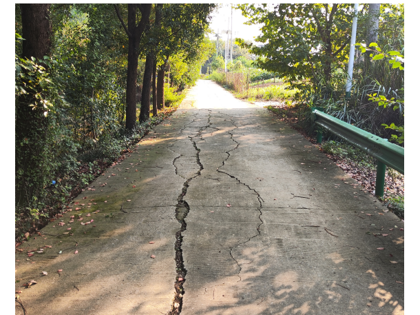
图4-2 连续纵向裂缝 (CK0+100)
