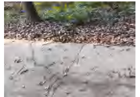
图4-2 局部角隅断裂
