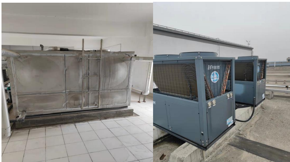
现有热水箱及空气能热泵热水机
