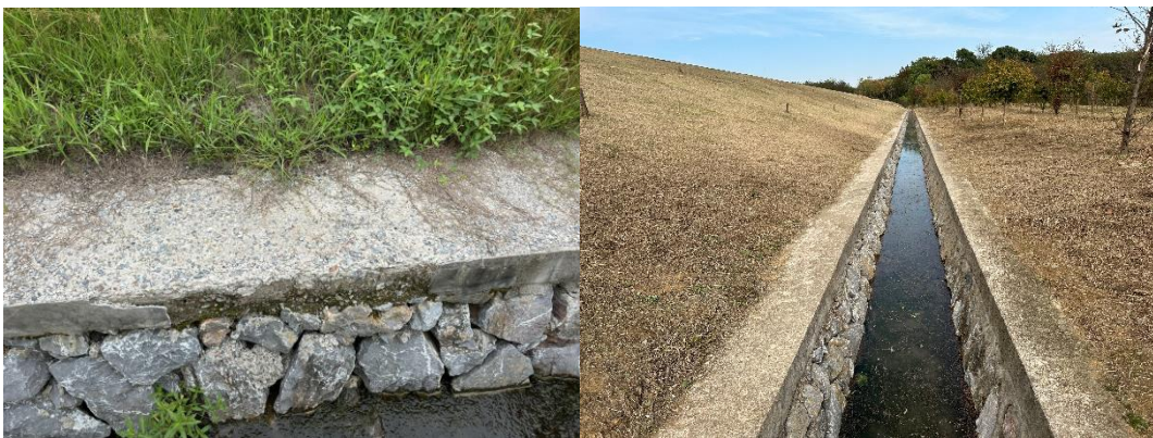
图 3-3 压顶风化、4 导渗沟积水照片
